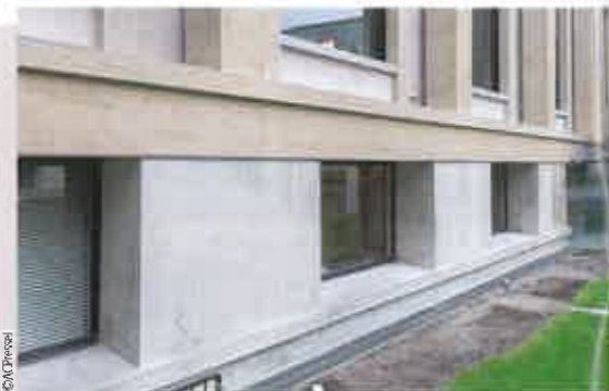
Au rez-de-cour, 7 zones ont été traitées avec différents produits et une laissée comme témoin.
