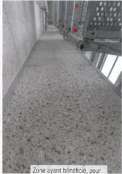
Zone ayant bénéficié, pour partie, d'une réparation.
